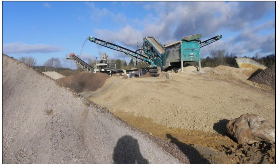
Vue sur les installations de traitement (crible au premier plan et cyclone au second plan)
