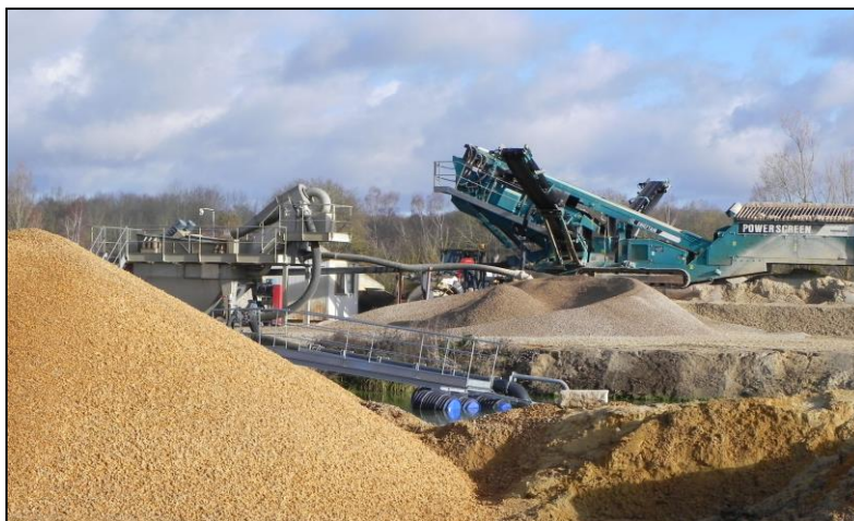
Vue sur le poste de criblage et poste de lavage
