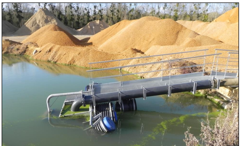
Vue sur la bassin d'eaux claires avec la pompe de reprise alimentant le poste de lavage. En arrière-plan se distinguent les stocks de granulats.
