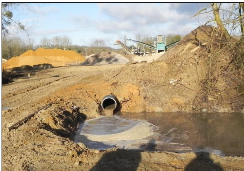
Buse d'amenée des eaux de lavage dans le bassin de décantation.
