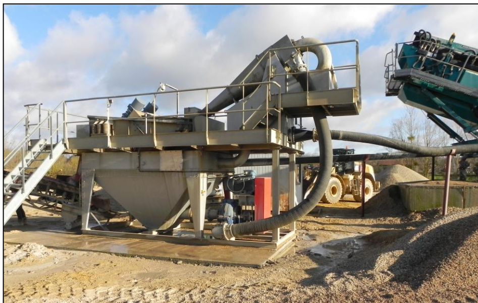
Vue sur le poste de lavage (cyclone)
